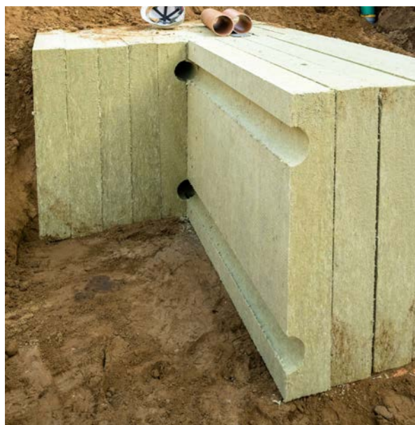
Regnvandssystem med Rockflow.
