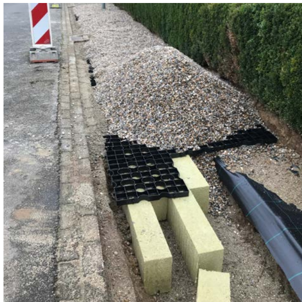
Regnvandshåndtering i et boligkvarter. Parkering kan ske ovenpå anlægget, som er installeret 40 cm under stabil grus.
